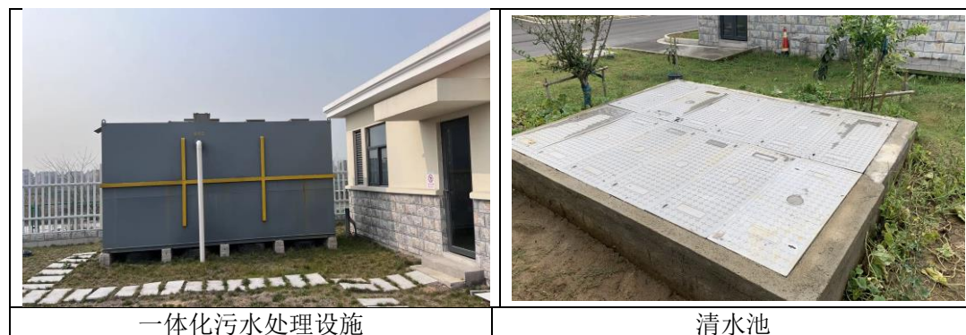
图 4-9 污水处理装置及清水池
