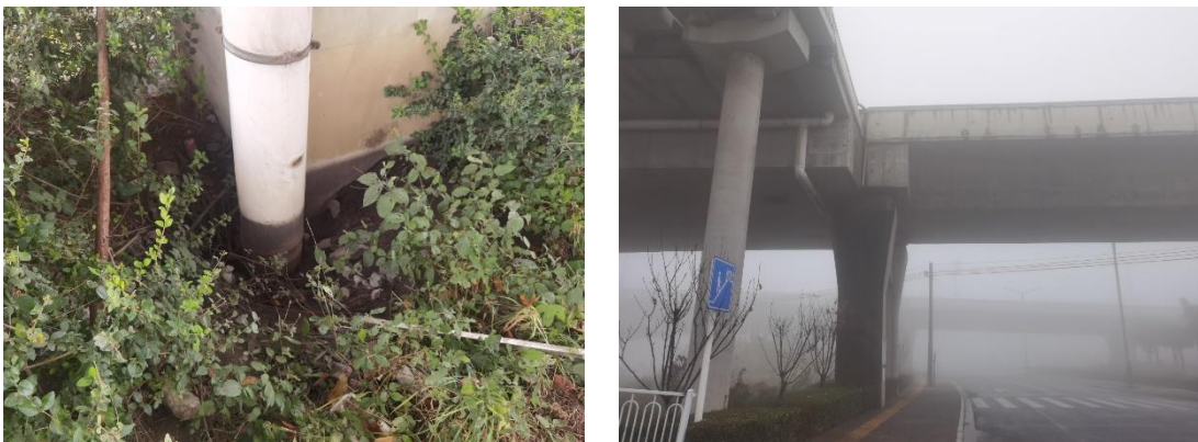
图8.3-1 径流收集管照片（引入地埋式事故池）
